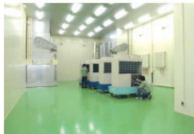
恒温室（さまざまな状況下における信頼性試験等を行うための設備）
