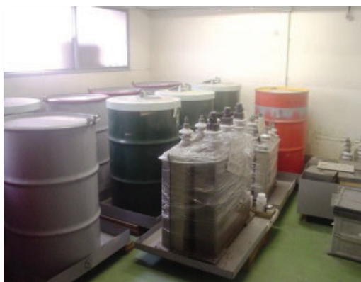
川崎本社のポリ塩化ビフェニル保管倉庫内
