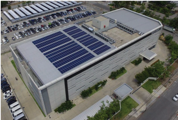
FUJITSU GENERAL ENGINEERING(THAILAND)CO.,LTD.の屋上に 新設した太陽光パネル
