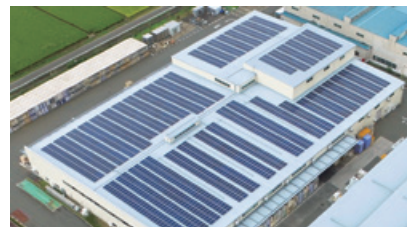
家電リサイクル事業を行う子会社(株)富士エコサイクルに設置した太陽光発電システム
