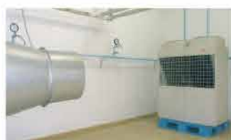
室外機測試室 測試即使在下雨或颱風的惡劣環境下，室外機依然能穩定運作。
