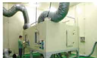
熱量計測室 測試空調的冷房 / 暖房能力。
